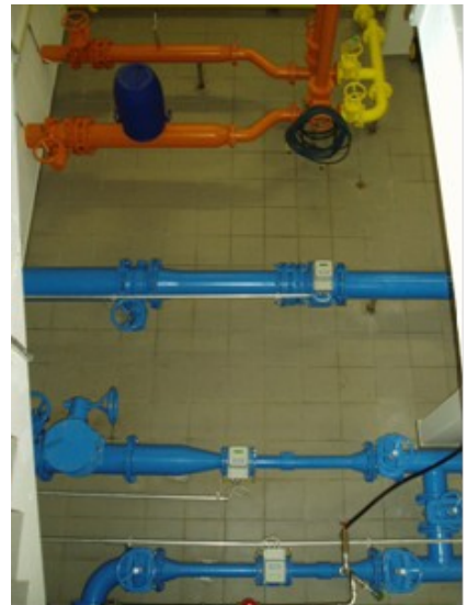
Réservoir et station de pompage village
