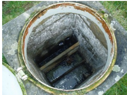
Chambre de captage les Granges
