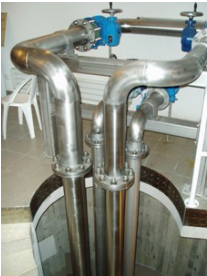
Puits de pompage des eaux Léchelles
